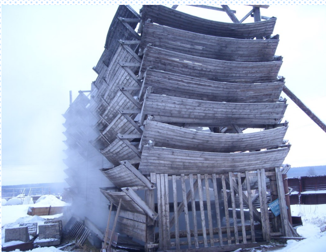
Градирия (система охлаждения воды на ДЭС)
