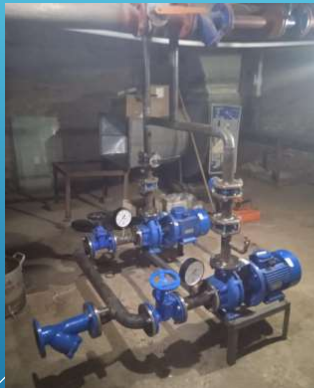
Насосная станции для увеличения водоотдачи внутренней системы противопожарного водоснабжения в д/с № 8
