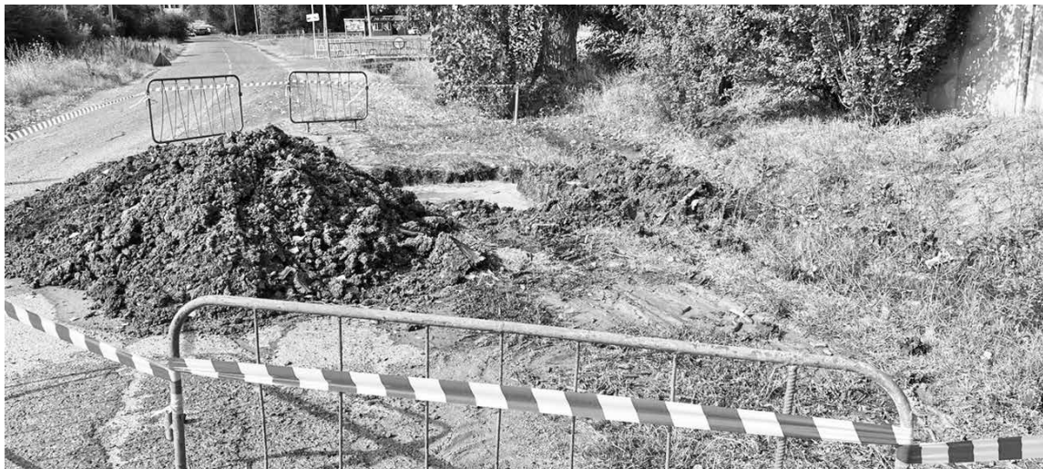
Место порыва водопроводной сети по городской улице Восточной. / фото: НАТАЛЬЯ МАСЛЕННИКОВА
