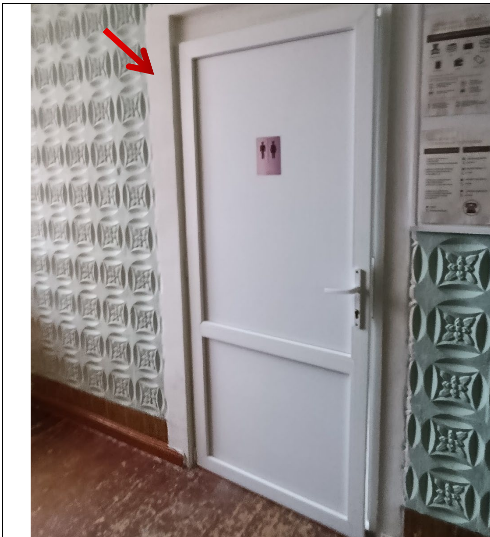
Фото № 13. Туалет. Дверной проем контрастно не маркирован.
