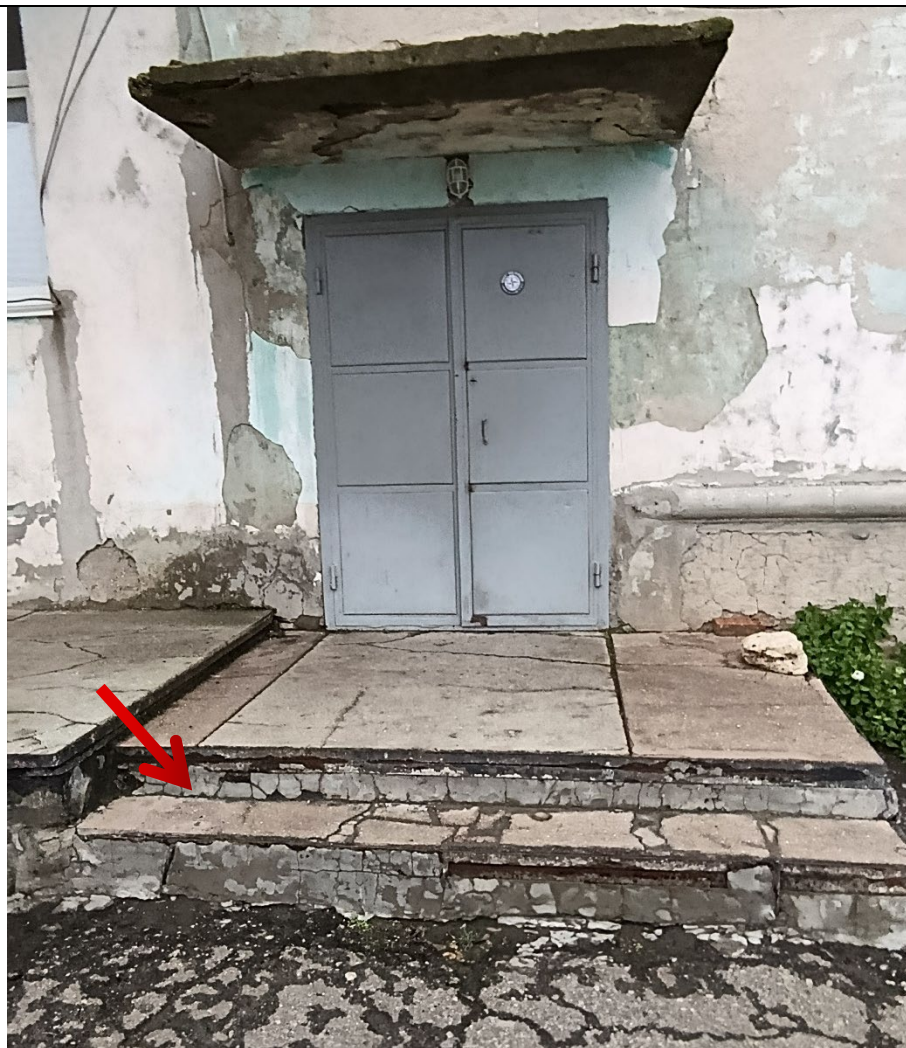
Фото № 9. Эвакуационный выход. Нет поручней на лестнице. Ступени контрастно не маркированы.
