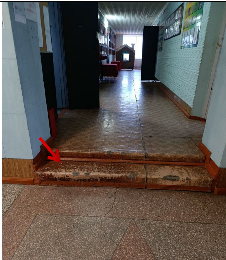
Фото № 5. Лестница по пути движения. Поручни отсутствуют. Краевые ступени контрастно не маркированы.
