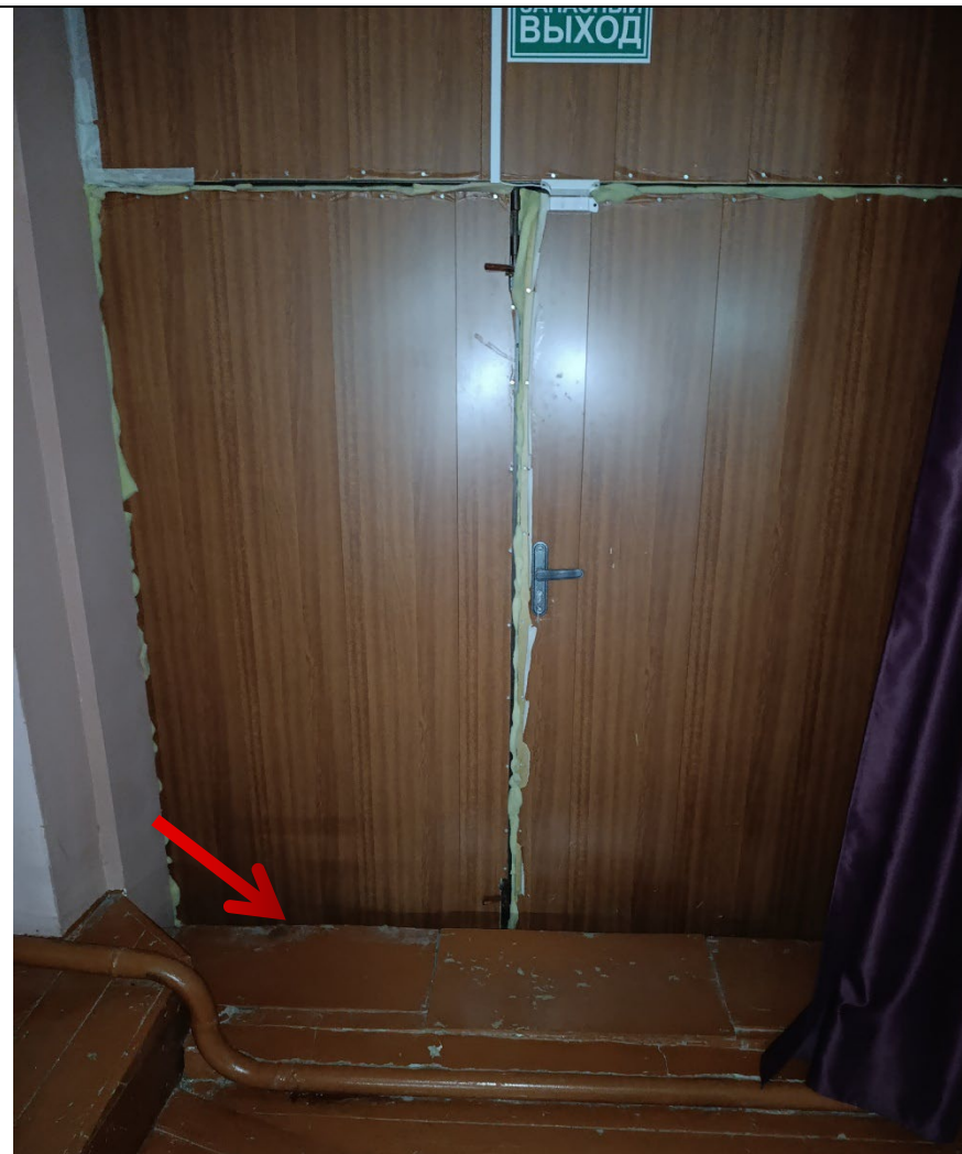
Фото № 10. Перепад высоты в дверном проеме.
