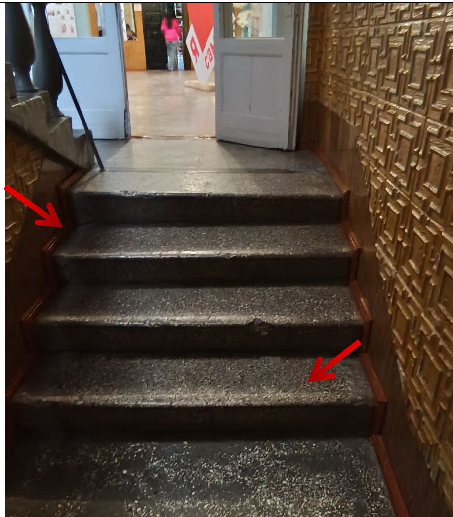
Фото № 6. Поручни на лестнице отсутствуют. Краевые ступени контрастно не маркированы.
