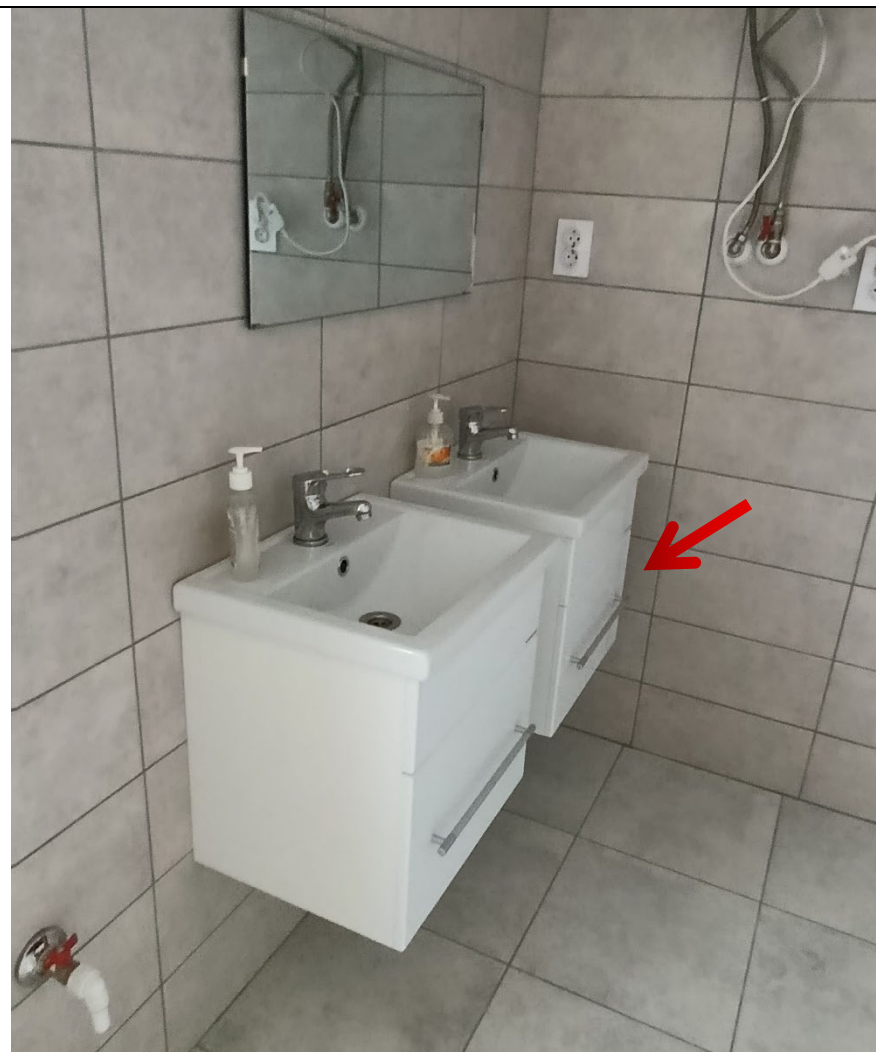
Фото № 14. Умывальник расположен на тумбе. Нет опорного поручня возле умывальника.
