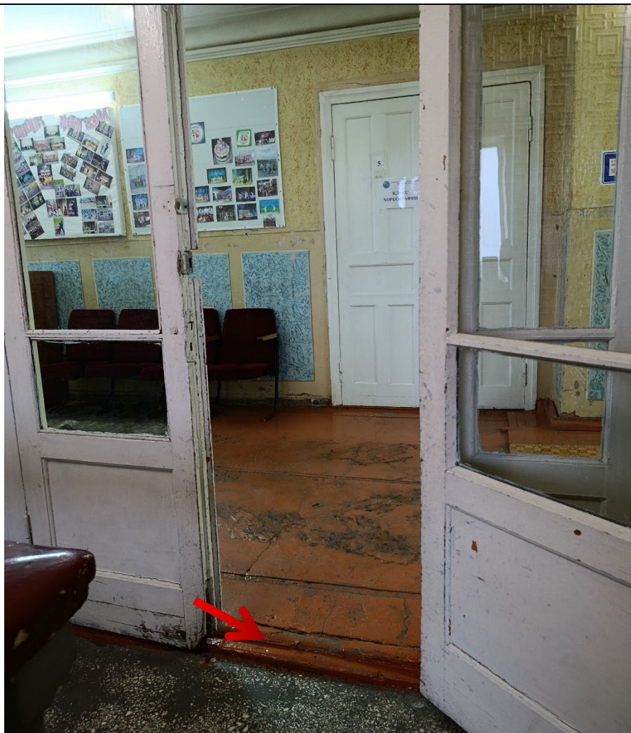
Фото № 7. Порог в дверном проеме. Дверной проем контрастно не маркирован.
