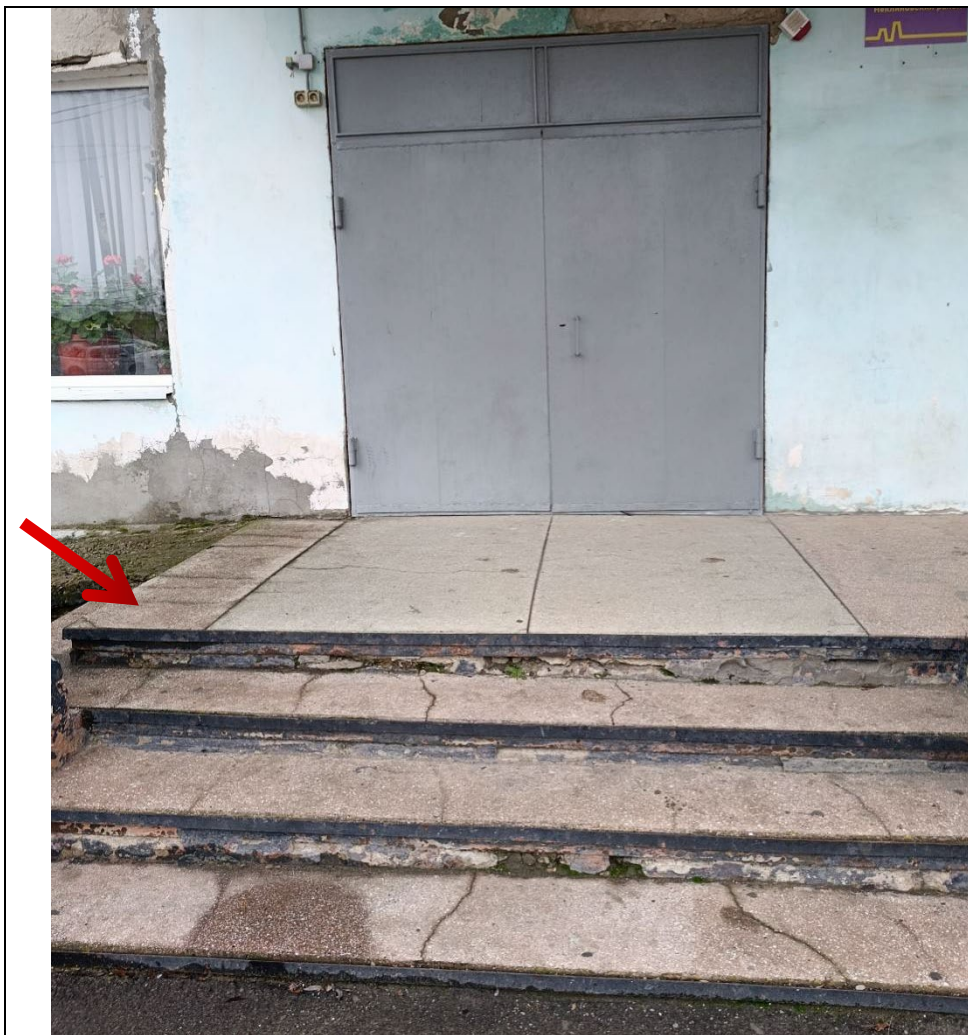
Фото № 3. Главный вход. Нет поручней на лестнице. Нет тактильной предупредительной разметки перед лестницей. Нет тактильной таблички об объекте.
