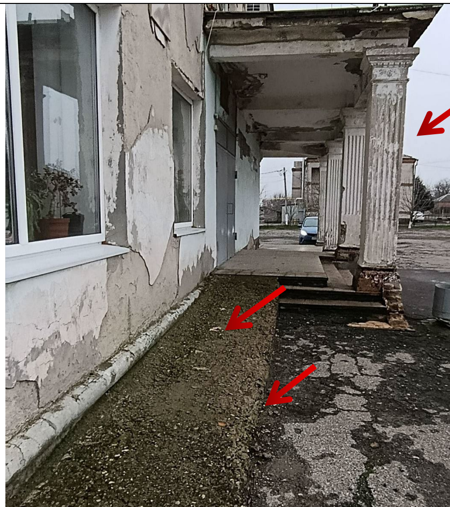
Фото № 4. Колонны контрастно не маркированы. Покрытие пандуса неровное. Нет бортиков и поручней на пандусе.
