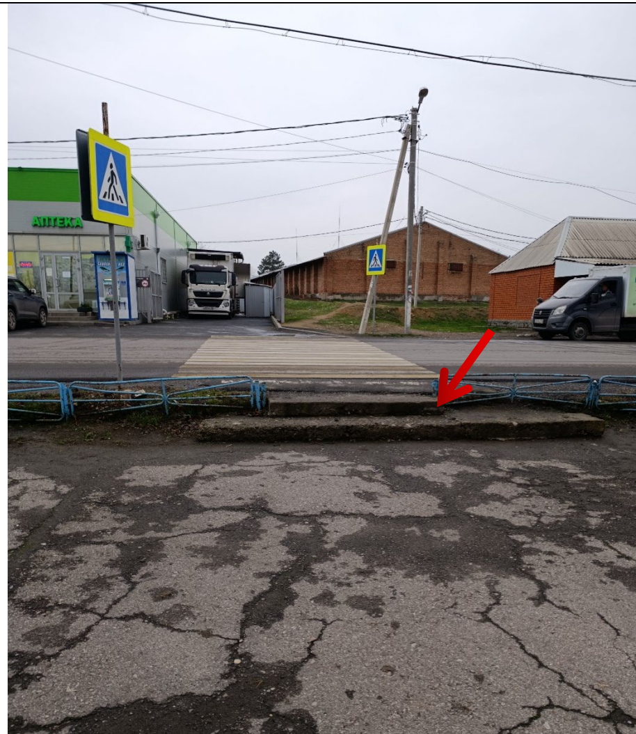
Фото № 2. Лестница на входе на территорию. Поручни отсутствуют
