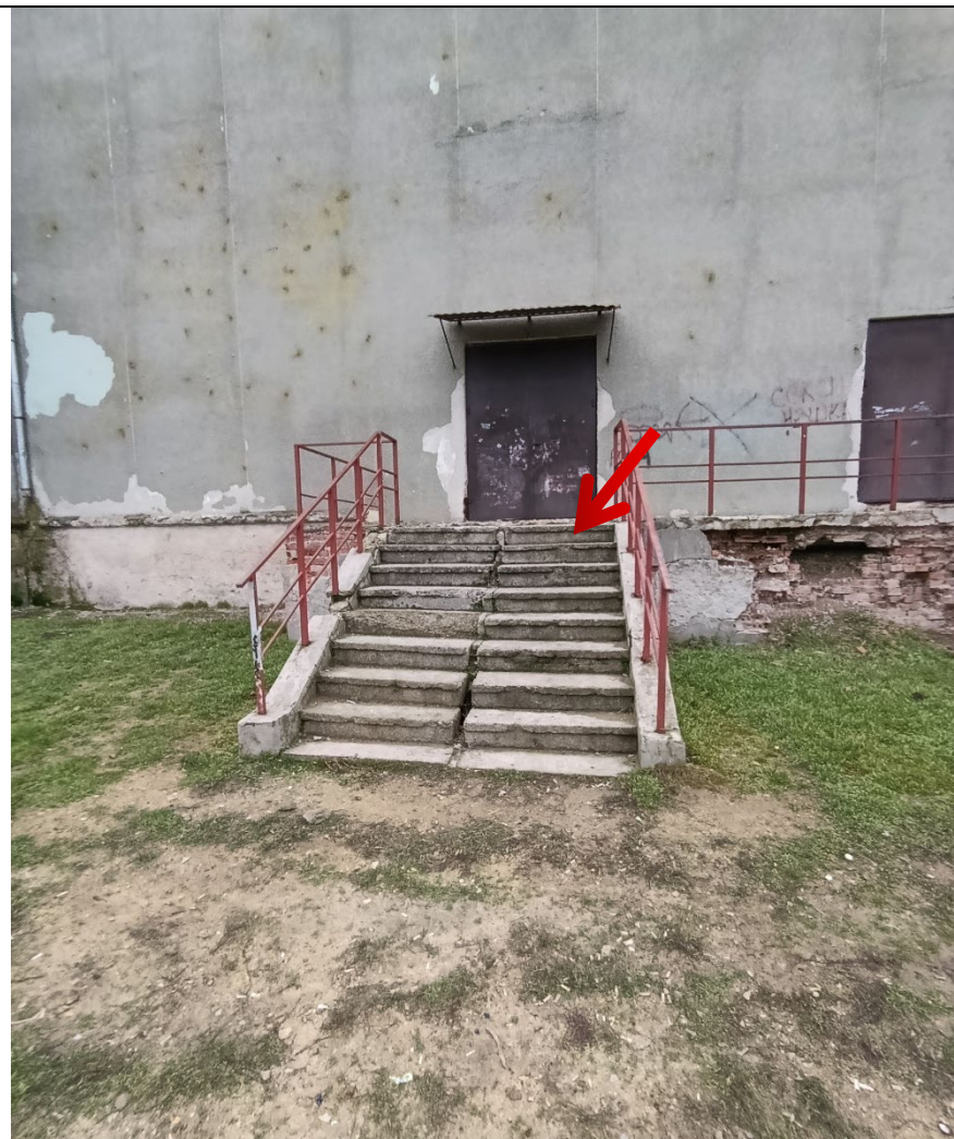
Фото № 8. Эвакуационный выход. Ступени лестницы частично разрушены. Краевые ступени контрастно не маркированы.
