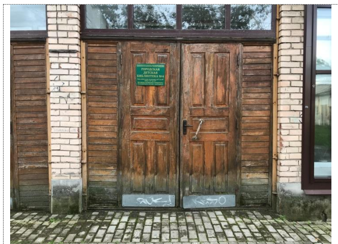
Фото №5 – Внешняя входная дверь
