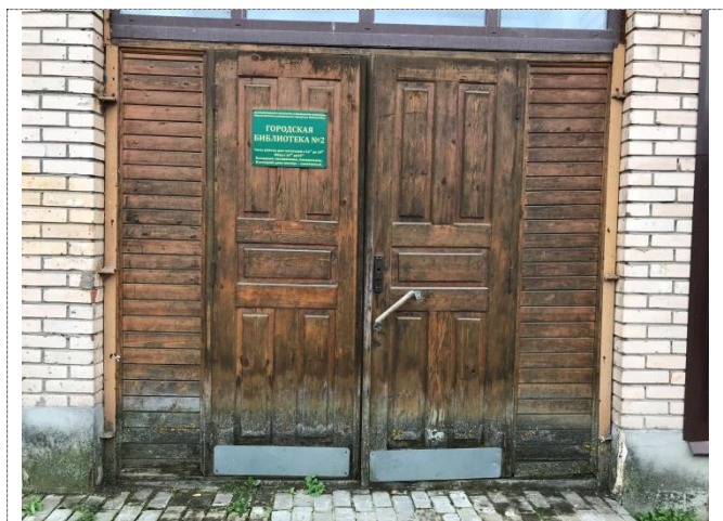
Фото №5 – Внешняя входная дверь
