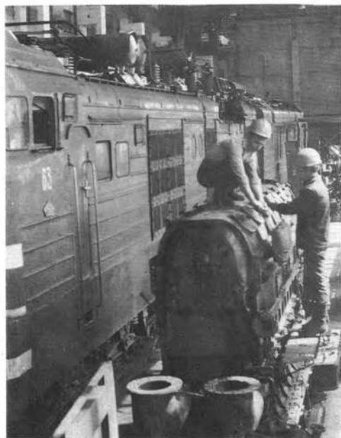
Участок ремонта локомотивов ОПЭ-1 Краснобродского ПТУ.
