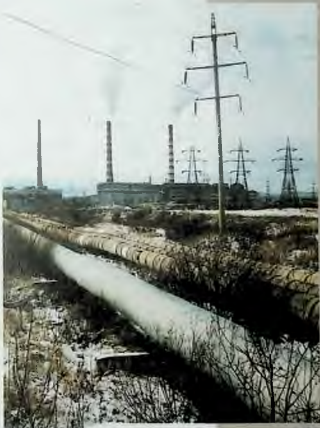
Теплотрасса Среднеуральск – Екатеринбург
