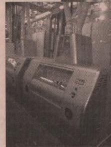
На заводе — современное оборудование
