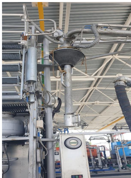
Рисунок 44 Оснащение автоматизированных систем налива нефтебаз телескопическими наконечниками
