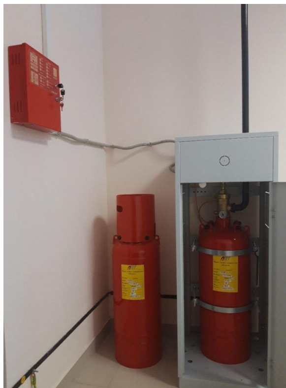
Рисунок 26 Система газового пожаротушения в помещении серверной АБК
