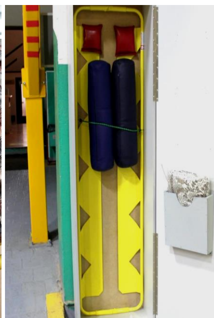
Рисунок 62 Шкаф с медицинскими носилками в производственном помещении
