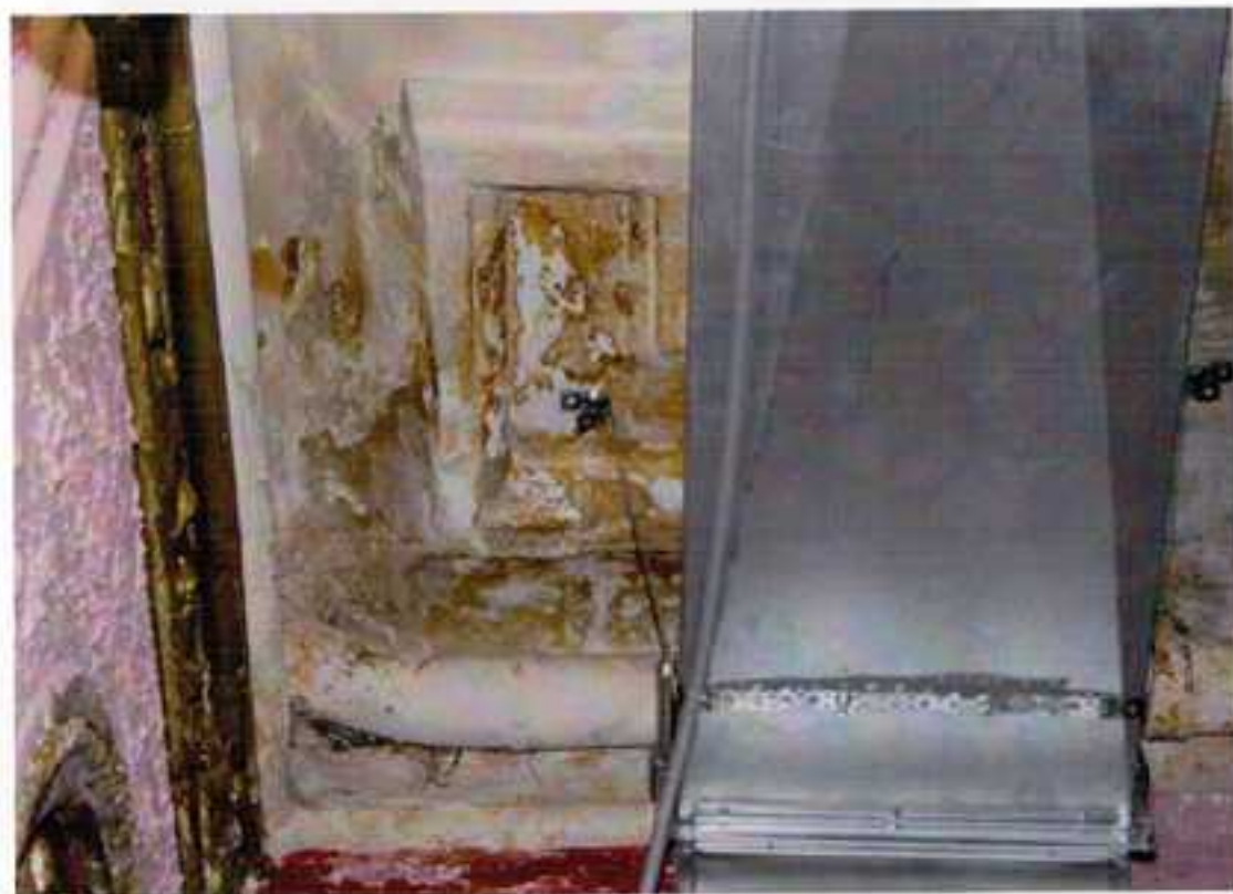
Фото 5 дефекты отделки вид снизу
