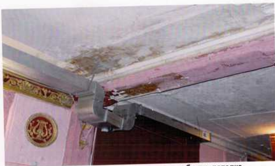
Фото 2 дефект отделочного покрытия балки потолка
