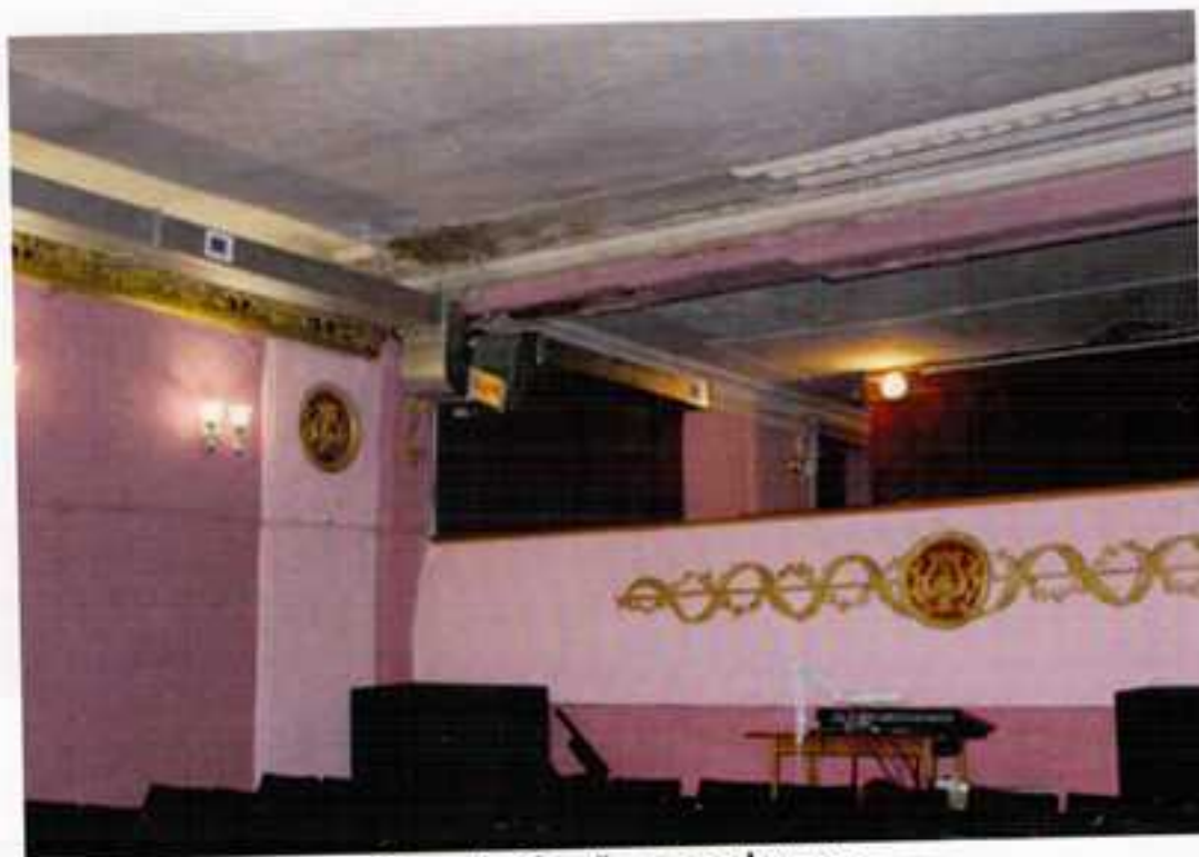
Фото 1 общий вид дефектов
