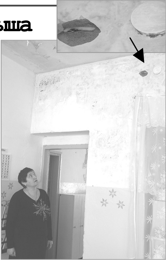
Протекающая крыша и замыкание электропроводки доставили немало переживаний заведующей детским садом «Колосок» Лилии Петровне Ждановой (на снимке) и коллективу детского учреждения.
