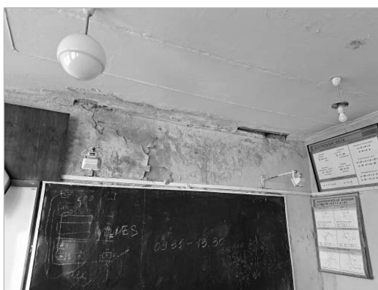
Из-за избыточной влажности на стенах Беловской школы внутри появилась плесень, начала обваливаться штукатурка в классных комнатах.
