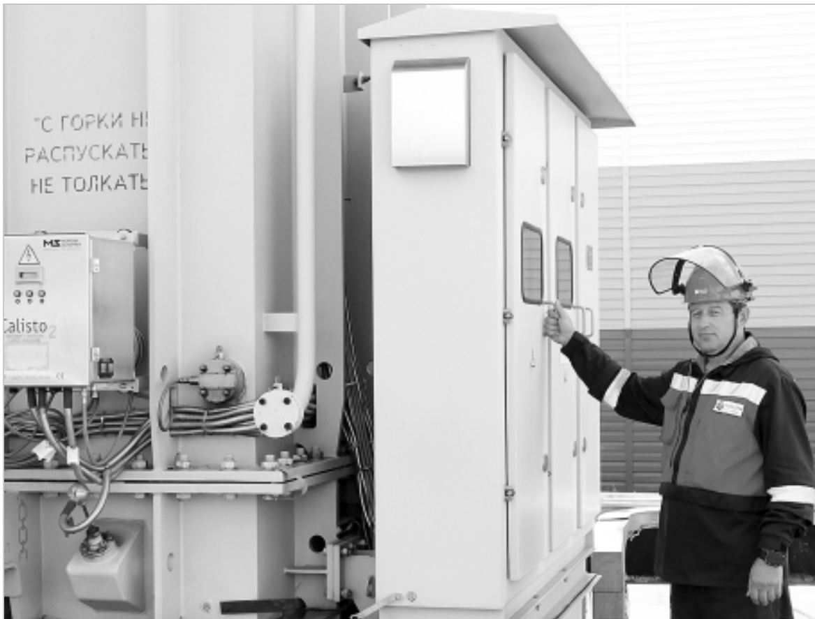
Около десяти лет дежурным электромонтером подстанции 220 кВ «Троицкая» работает Сергей Денисов .
