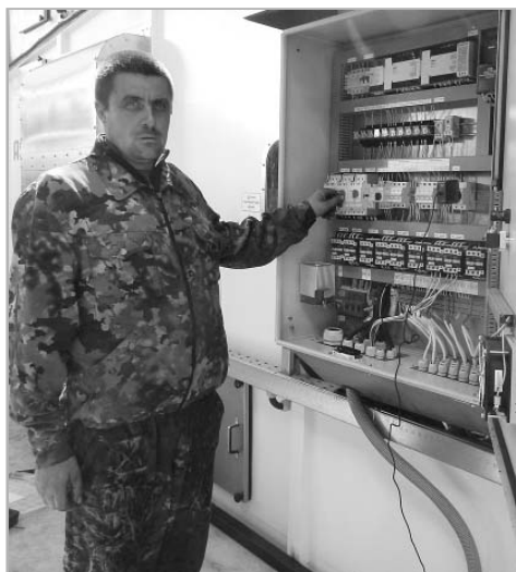
Для постоянной работы сушилки требуется три подготовленных оператора. Один из них – Сергей Владимирович Полищук, он изучает работу приборов и пульт управления.
