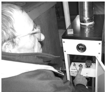
Одноконтурный котел «Яик» в доме Юрия Никитовича Мартьяхина позволяет экономить даже на газовом отоплении, так как КПД котла 92 %.
