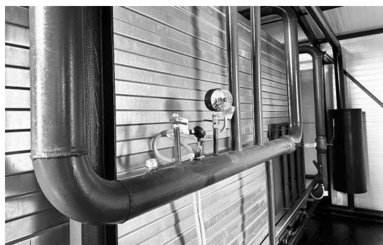
В новой котельной п. Линеvский Смоленского района.
