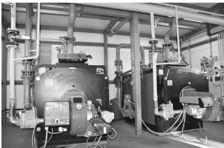
Автоматические газовые котельные работают без постоянного присутствия обслуживающего персонала, для этого закладывается специальная программа с определенным температурным графиком.
