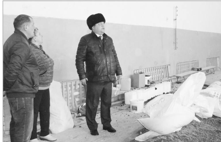
12 ноября глава района А.В. Овсянников посетил эти объекты (на снимке — Андрей Владимирович в Хайрюзовской школе), чтобы посмотреть, как идет ремонт, и проконтролировать ход работ.
