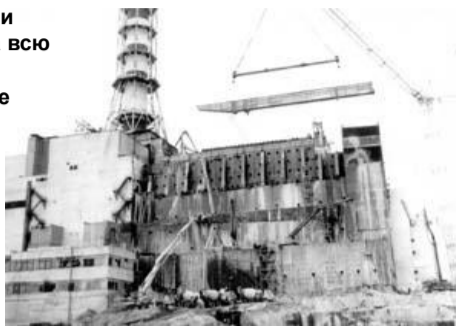
Над реактором начинают сооружать защитный саркофаж из бетона высотой 74 метра (высота 24 этажного дома), который впоследствии был назван «Укрытие».
