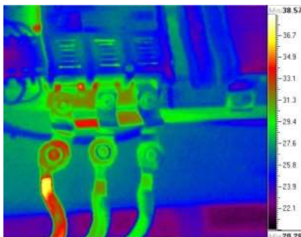
Рисунок 21. Пример термограммы контактных соединений с температурной шкалой
