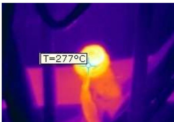
Рисунок 22. Пример обнаружения пожароопасного разогрева болтового контактного соединения
