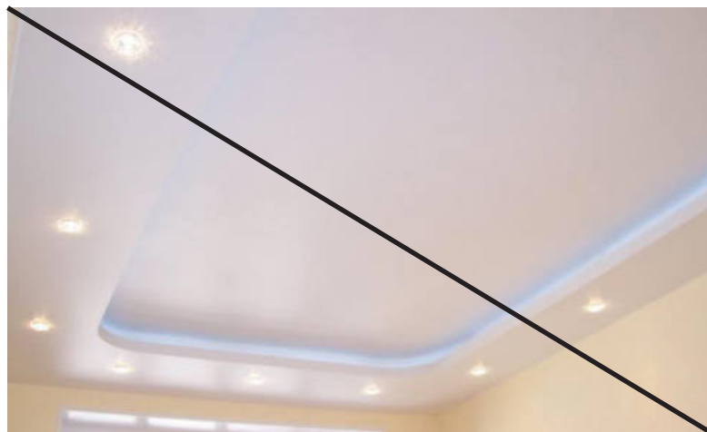
Плохо Многоуровневые гипсокартонные конструкции
