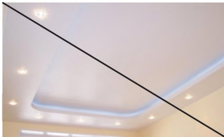
Плохо Многоуровневые гипсокартонные конструкции
