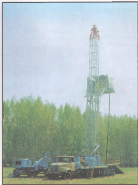
Такие агрегаты для подземного ремонта скважин производятся в Кунгуре
