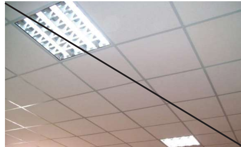
Плохо Открытые направляющие
