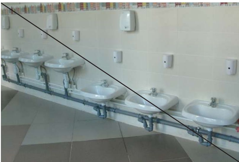
Открытые неаккуратные коммуникации визуально портят гигиеническую зону, собирают пыль и требуют постоянной чистки
