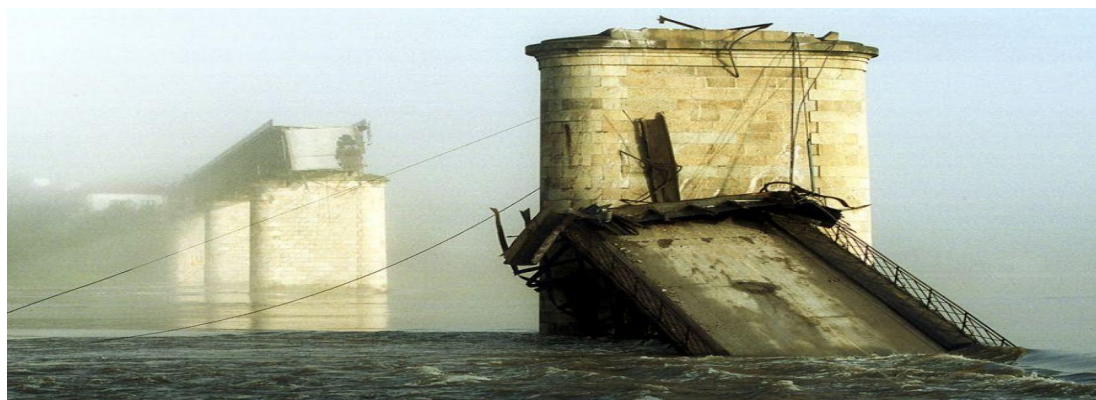
Рисунок 1 – Разрушение пролетной части моста
