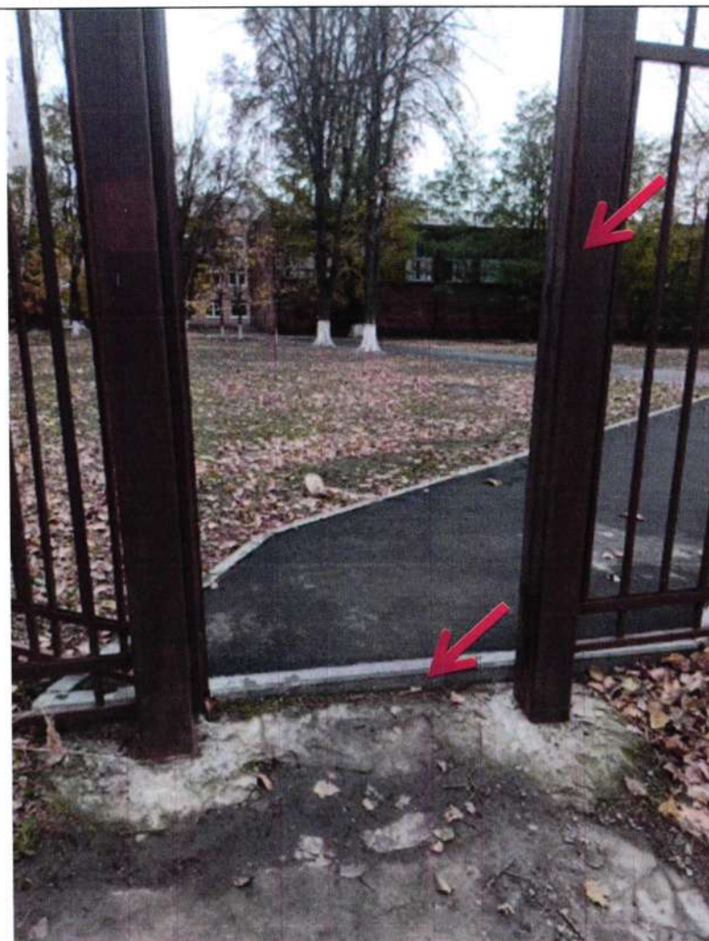
Фото № 2. Дополнительный вход. Проем калитки контрастно не маркирован. Перепад высоты в проеме калитки
