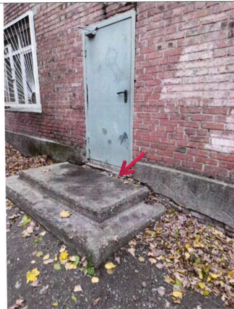
Фото № 16. Перепад высоты в дверном проеме. Нет поручней на лестнице
