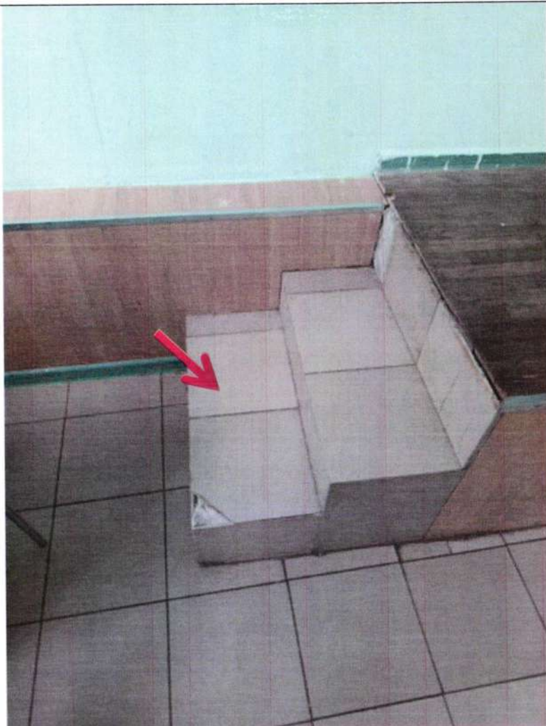
Фото № 27. Лестница на сцену. Нет поручней. Ступени контрастно не маркированы.
