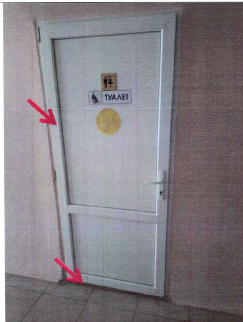
Фото № 32. Дверной проем контрастно не маркирован. Порог в дверном проеме.
