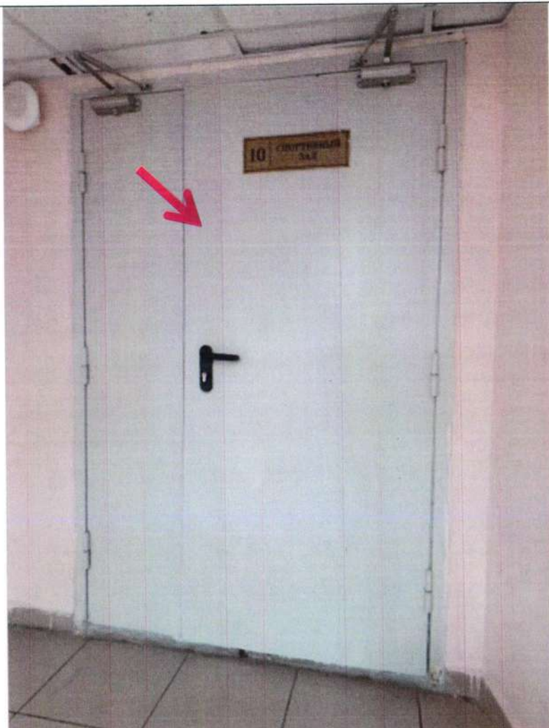
Фото № 23. Дверной проем контрастно не маркирован. Табличка не тактильная.
