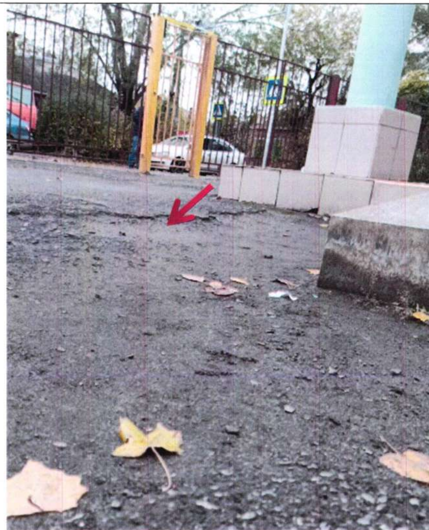
Фото № 4. Покрытие путей движения по территории имеет неровности
