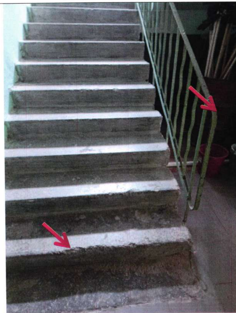
Фото № 20. Эвакуационная лестница. Ступени контрастно не маркированы. Поручни короче марша лестницы.
