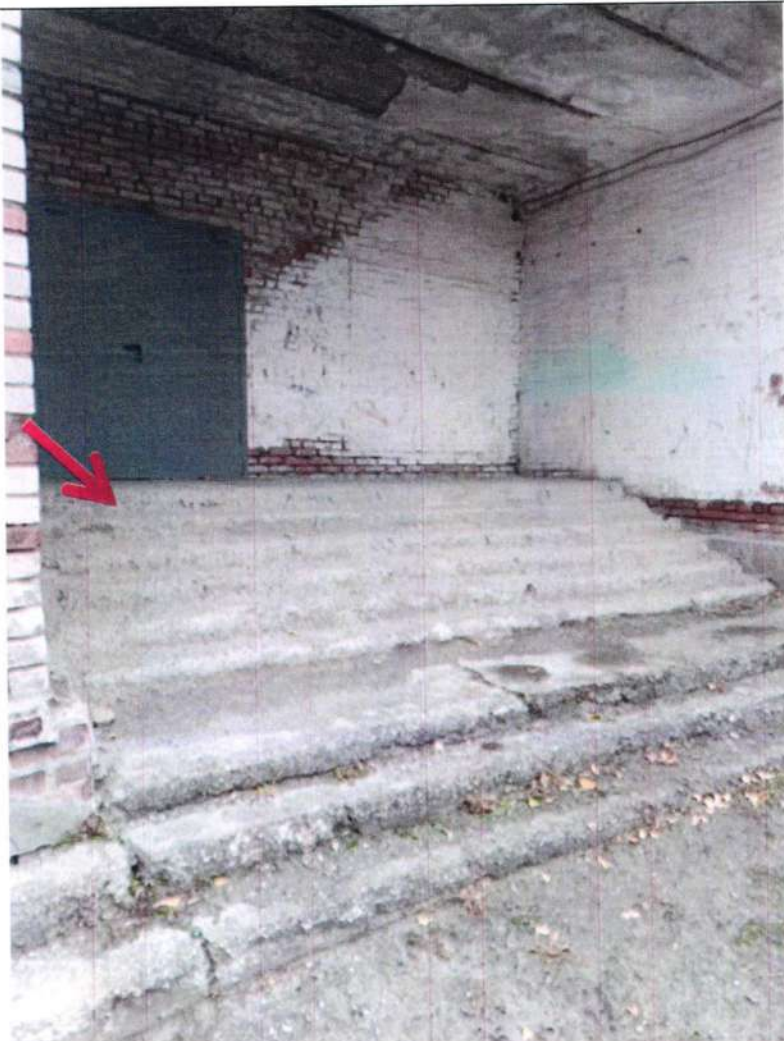
Фото № 19. Эвакуационный выход с левой стороны здания. Ступени частично разрушены, контрастно не маркированы. Нет поручней на лестнице.
