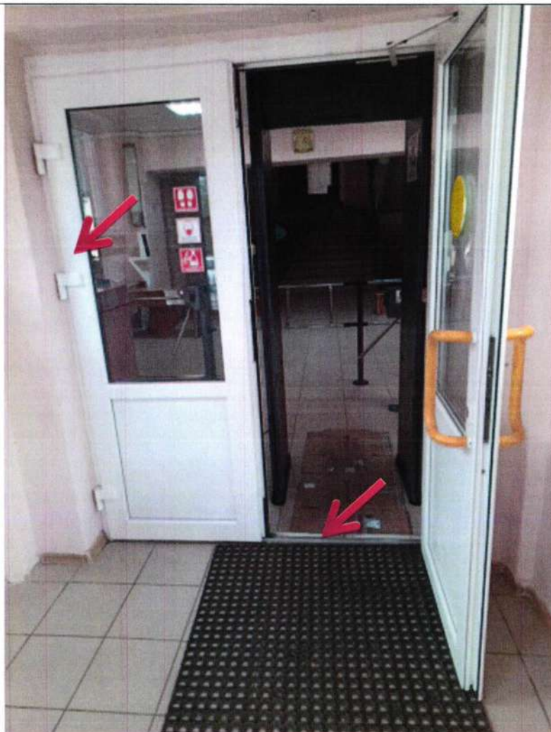
Фото № 9. Тамбур. Дверной проем контрастно не маркирован. Порог в дверном проёме
