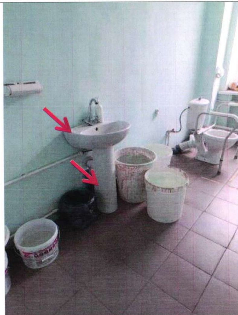
Фото № 30. Универсальная доступная кабина. Умывальник на пьедестале. Нет опорного поручня, крючка для костылей
