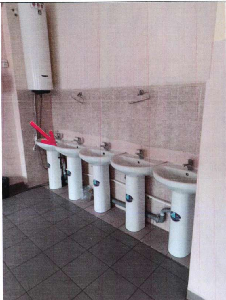
Фото № 25. Нет поручня возле умывальника в столовой. Умывальники на пьедесталах
