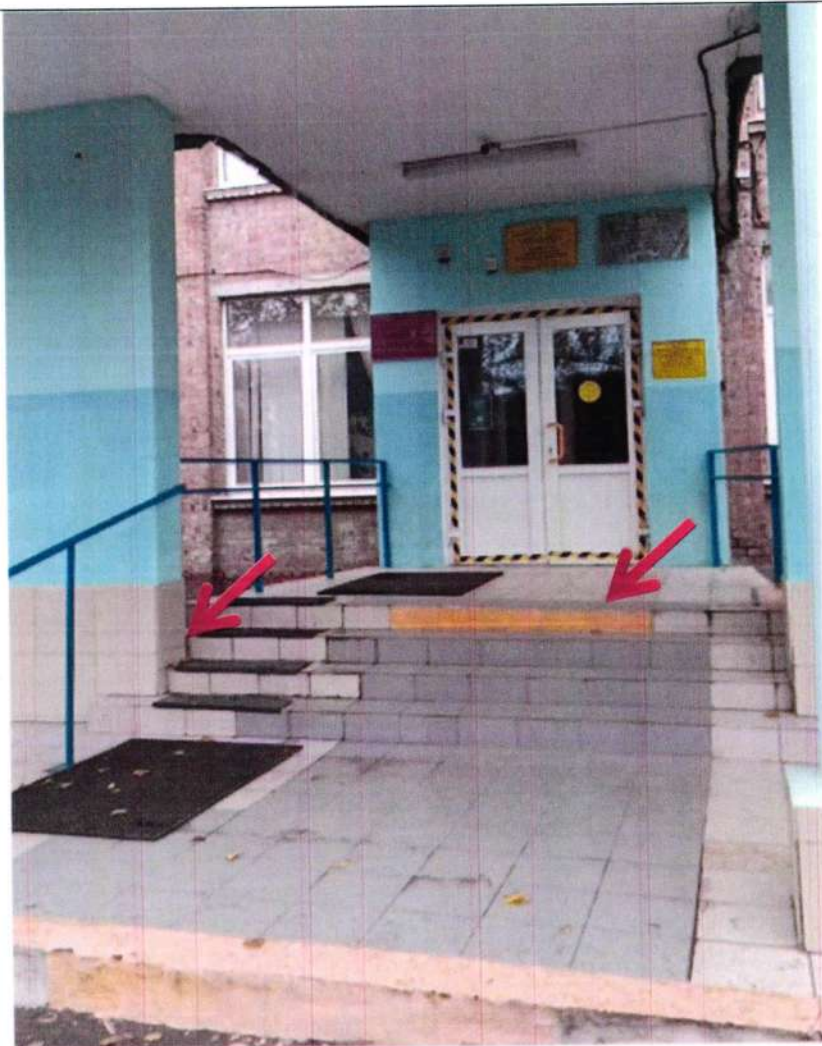
Фото № 5. Главный вход. Ступени контрастно не маркированы. Нет поручней на лестнице
