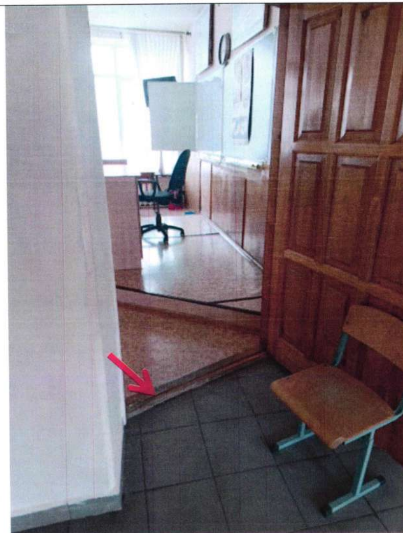
Фото № 22. Порог в дверном проеме
