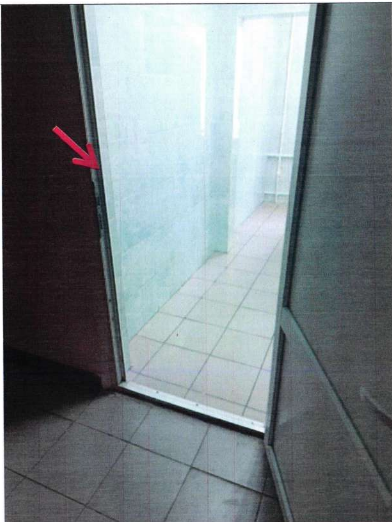
Фото № 29. Дверной проем контрастно не маркирован. Порог в дверном проеме
