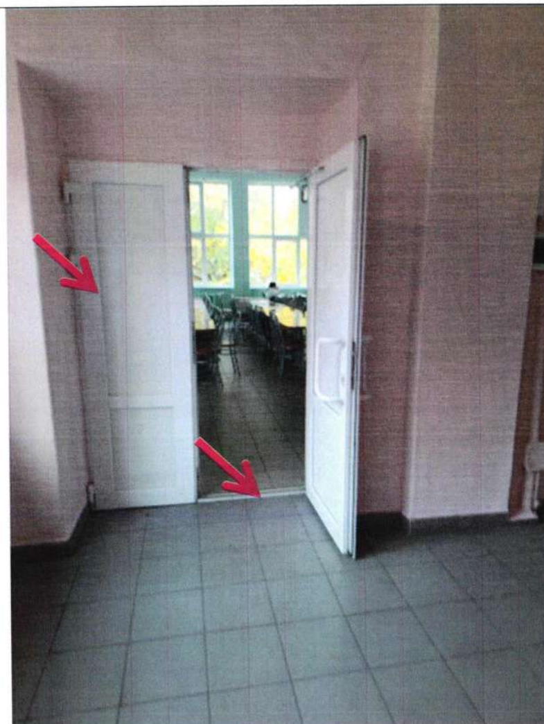
Фото № 26. Порог на входе в столовую. Дверной проем контрастно не маркирован
