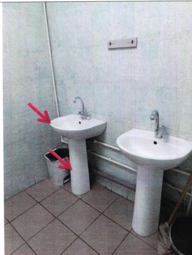
Фото № 28. Умывальник на пьедестале. Нет опорного поручня, крючка для костылей
