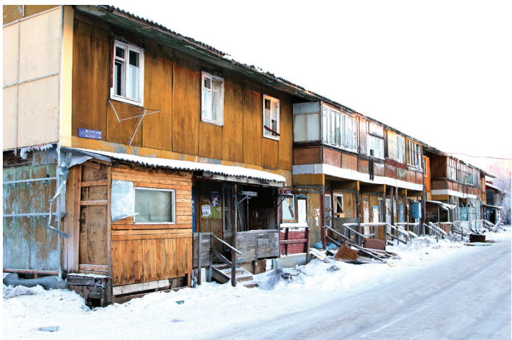
Расселённый аварийный дом №20/1 мкр. №1 подлежит сносу
