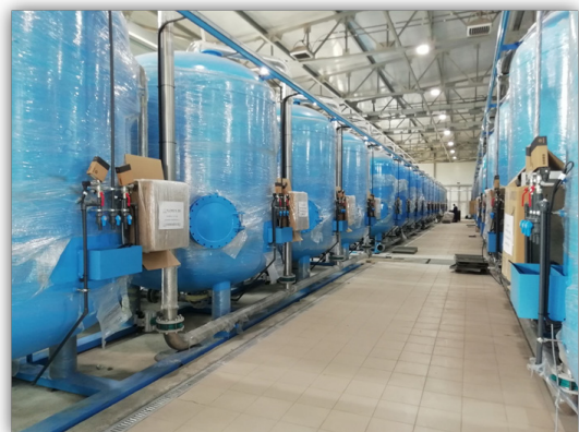
Рисунок №9 – Механические фильтры станции обезжелезивания №1 г.п. Лянтор
