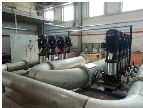
Рисунок №11 – Насосная станция второго подъема станции обезжелезивания №1 г.п. Лянтор
