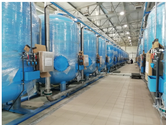
Рисунок №9 – Механические фильтры станции обезжелезивания №1 г.п. Лянтор
