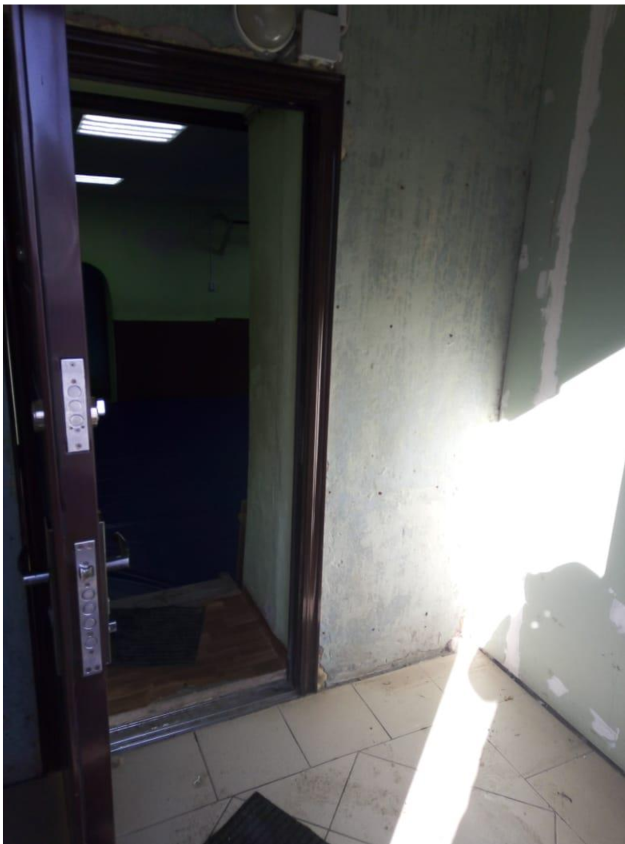
Тамбур эвакуационного выхода освобожден от мебели (ул. Тверская, 42).
