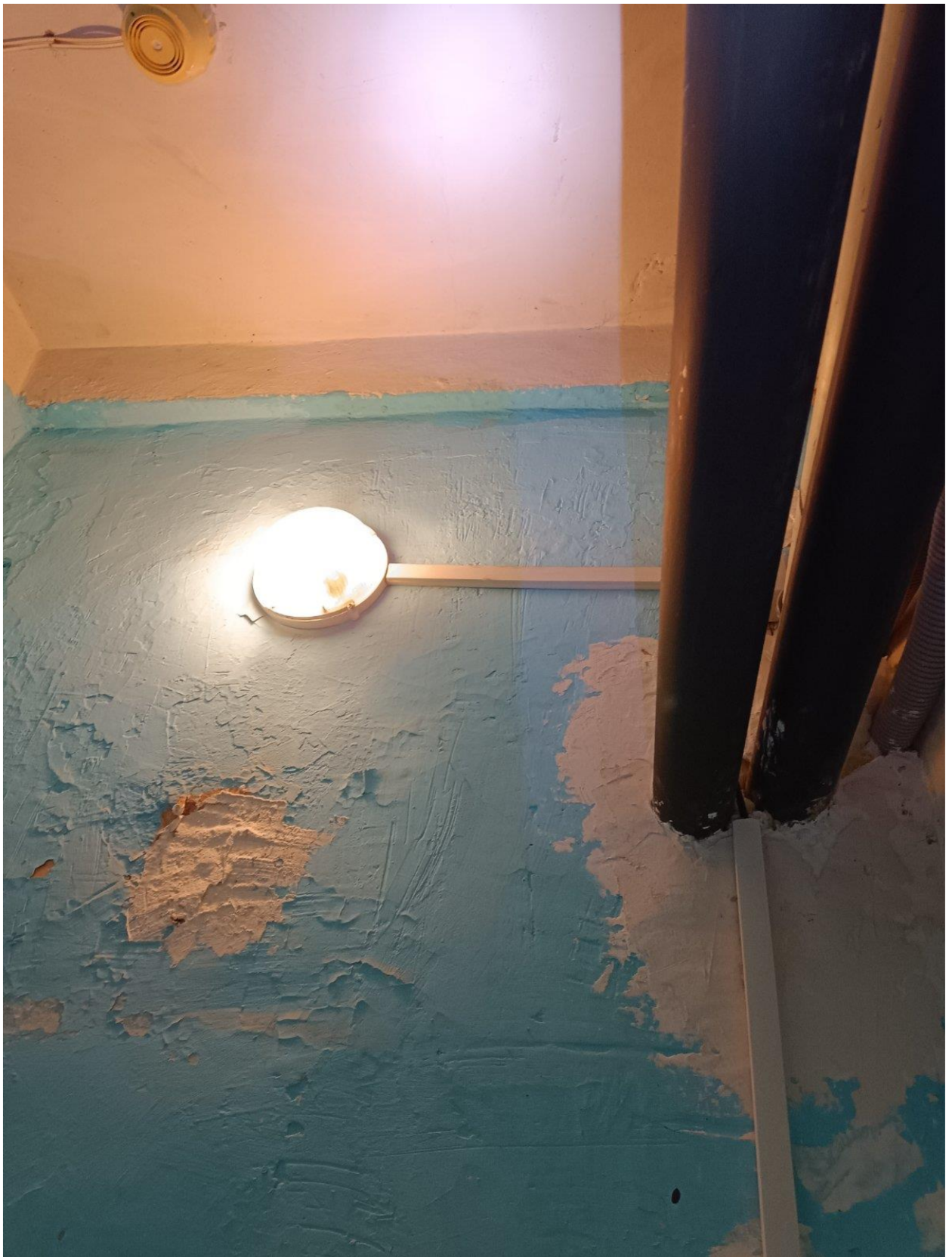
В коридоре светильник закрыт колпаком (рассеивателем) (ул. Тверская, 42).
