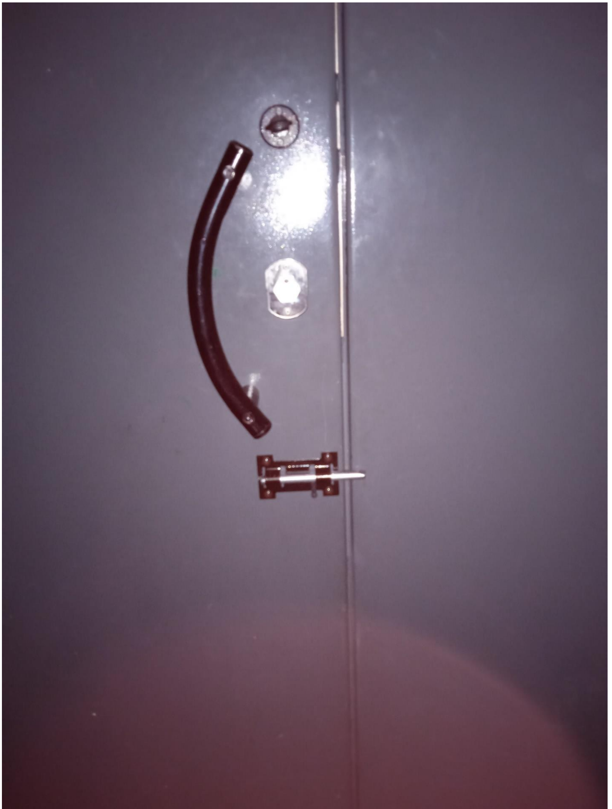
На дверь второго эвакуационного выхода установлен запор, что обеспечивает возможность их свободного открывания изнутри без ключа (ул. Тверская, 52).
