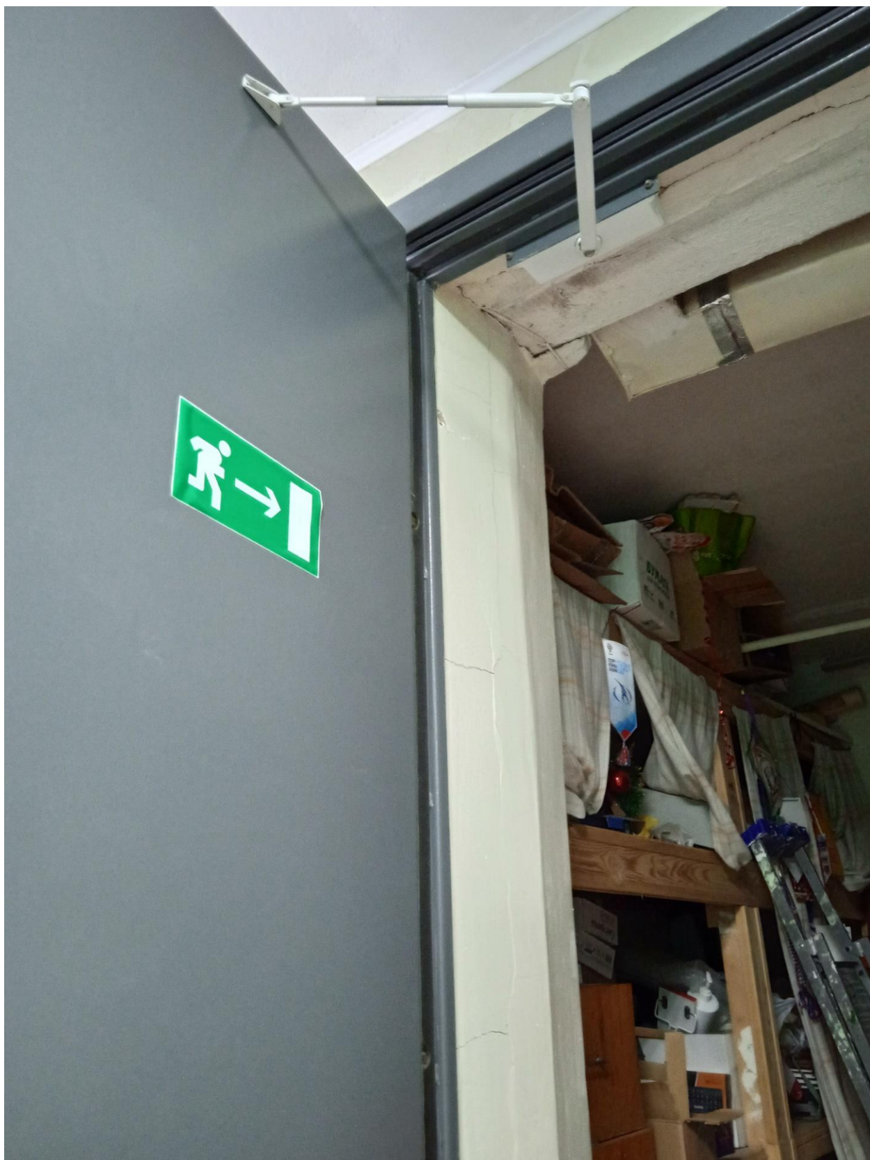
Устройство для само закрывания противопожарной двери в складе (ул. Тверская, 52)
