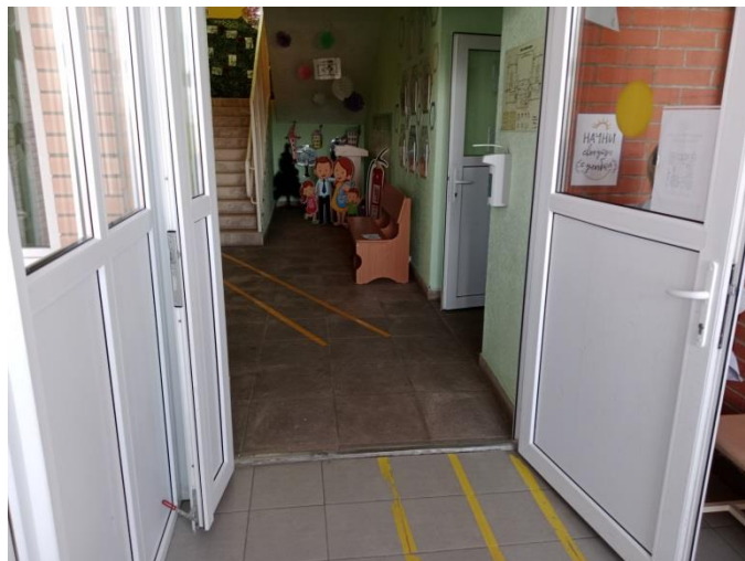
Фото 24 - Дверь(и), пути эвакуации (в т.ч. зоны безопасности)
