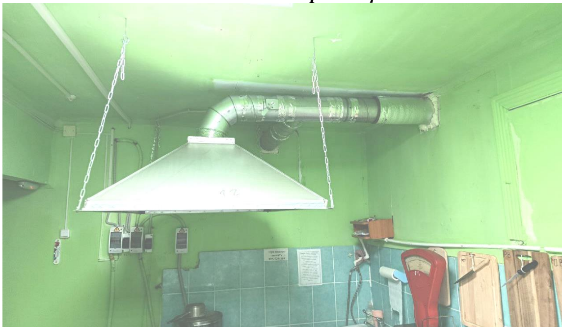
Фото вентиляции на пищеблоке Над плитами в горячем цехе
